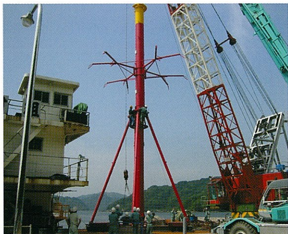
実験装置支持架台
